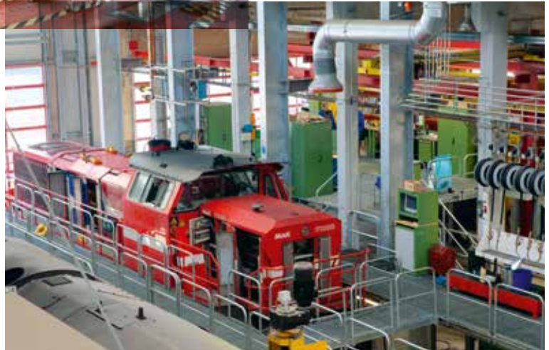
Moderne LED-Technik auf dem KVB-Betriebshof Nord und in der HGK-Lokwerkstatt reduzieren die CO 2 -Emissionen um 41,5 Tonnen pro Jahr.
